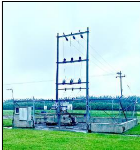
Figura 3. Estación de Red Pública.
