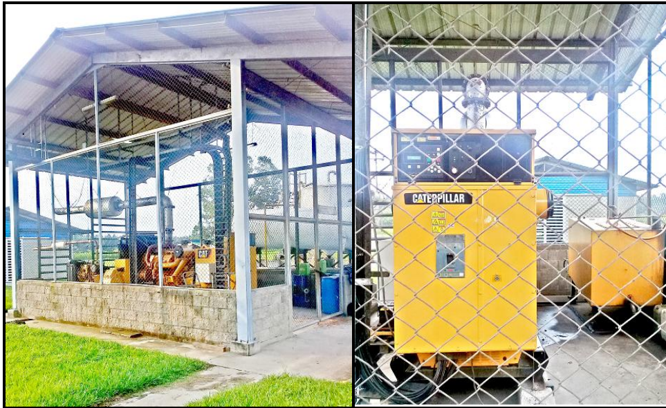
Figura 2. Estación Planta DIÉSEL.
