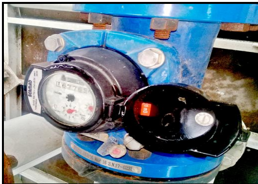
Imagen 5. Macromedidor de Agua Filtrada
