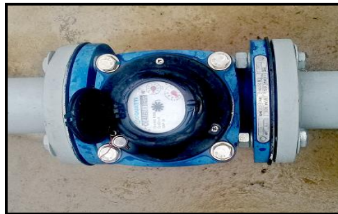
Imagen 7. Macromedidores de Agua para Caldera o Agua Suavizada
