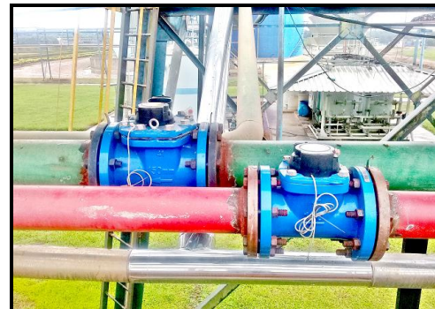
Imagen 6. Macromedidores de Agua para Proceso y Agua para Servicios
