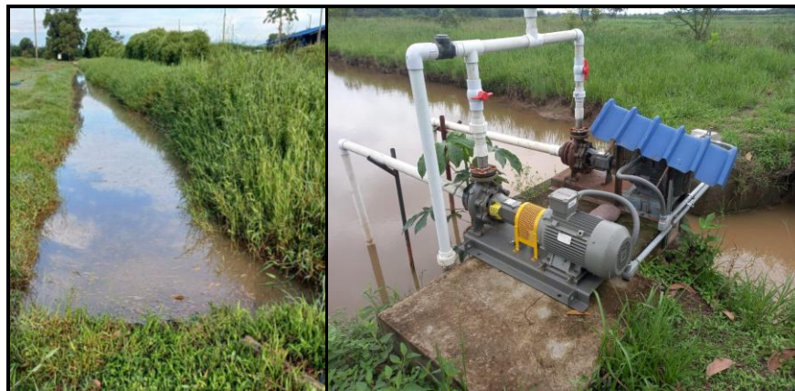
Imagen 1. Captación de Agua Superficial.
