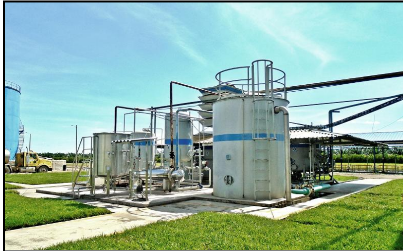
Imagen 4. Planta de Tratamiento de Agua.
