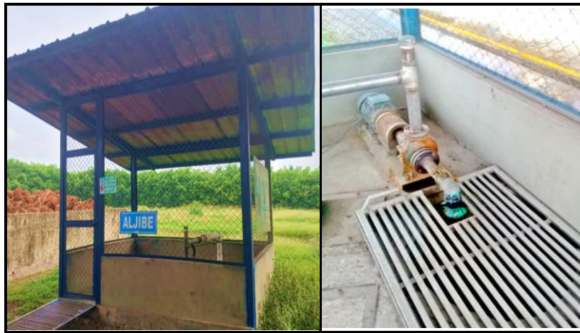
Imagen 2. Captación de Agua Subterránea.
