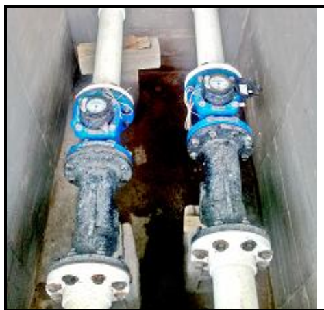
Imagen 3. Macromedidores para Captación de Agua Superficial y Subterránea
